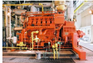
消化ガス発電
