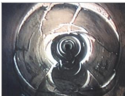
老朽化した下水道管
